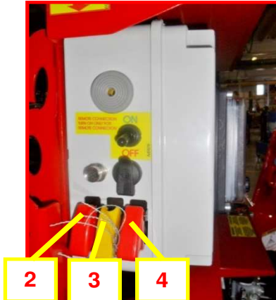
Afbeelding 5: linkerzijde van de schakelkast.
